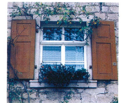
Bei Neubauten sind in jedem Falle Klappläden aus Massivholz gegenüber Rolläden vorzuziehen. Konstruktionsformen sind Bretterläden mit Gratleisten und Rahmenkonstruktionen mit Füllungen oder schrägen Lamellen.
