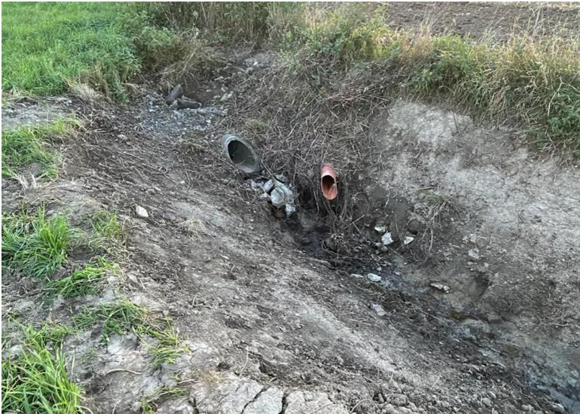
Einmündung des Abwassers in den Graben nördlich von Trag (Foto: W. Fahrnbauer)
